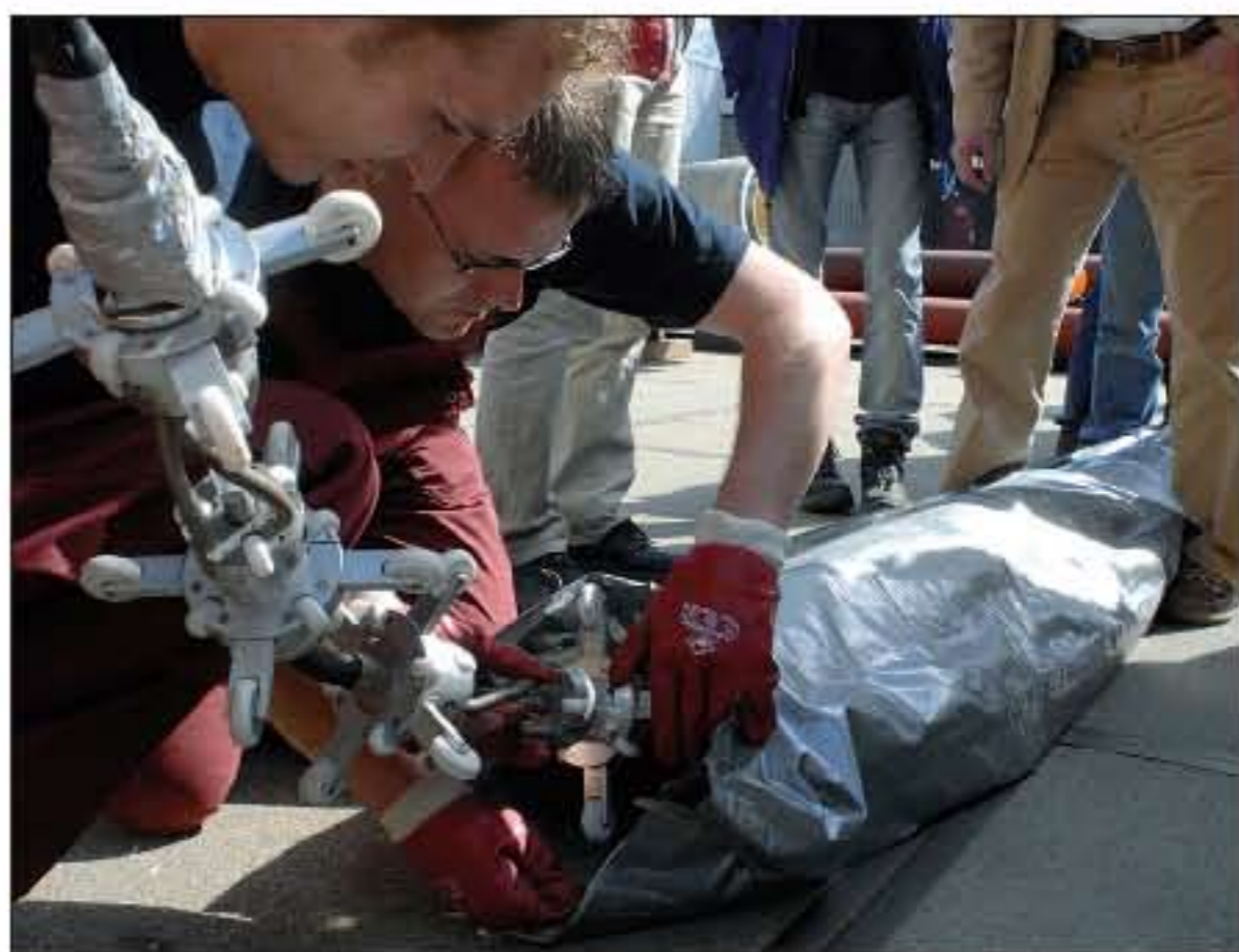
Lampen met een regelbare lichtsterkte worden in de liner gevoerd.
